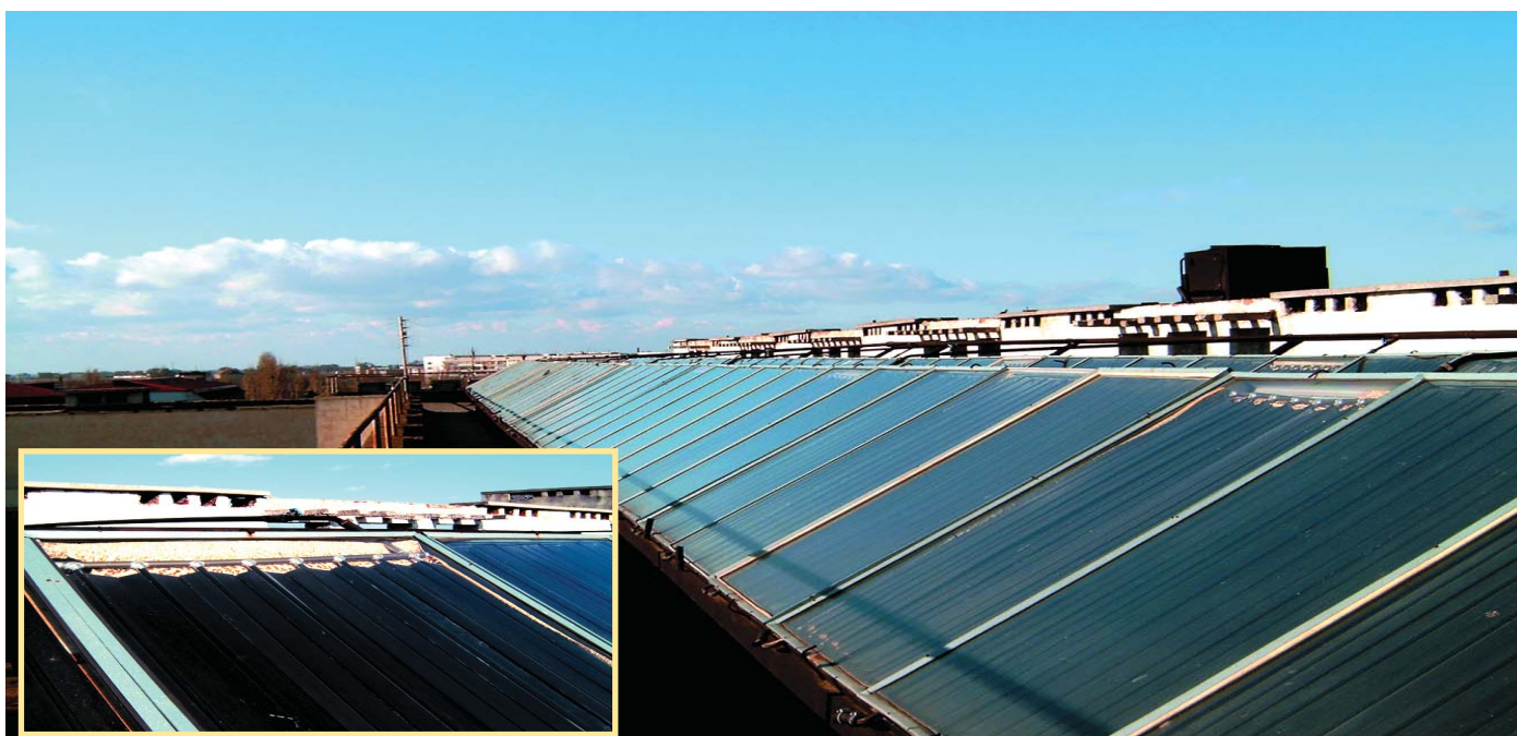
Сонячні колектори на даху пансіонату Північний, АР Крим
